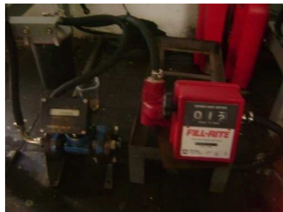
Gambar 4. Pengamatan pemakaian BBM dengan Flow meter
