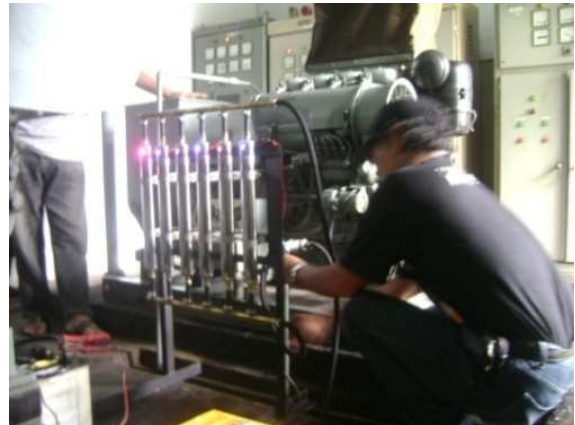
Gambar 3. Instalasi EFT pada Genset Stamford kapasitas 35 KVA
